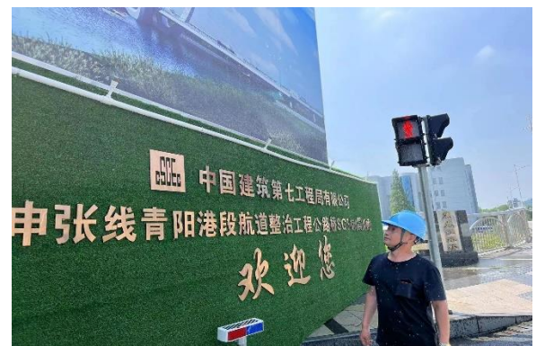
施工围挡喷淋
