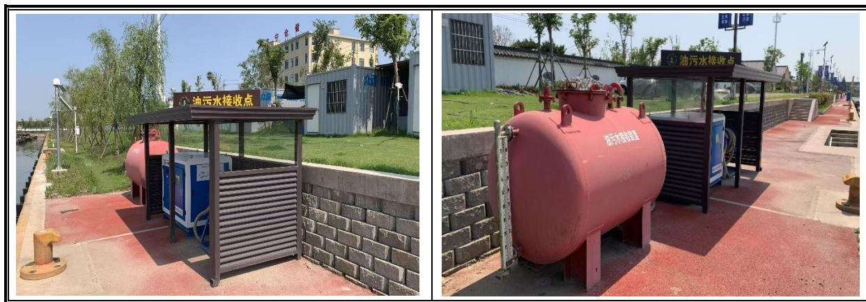
图 6.2-1 船舶油污水接收装置
