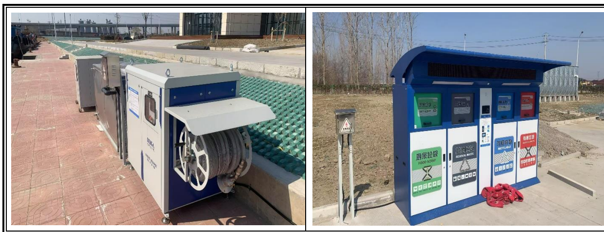
图 9.2-1 服务区固废及油污水接收装置
